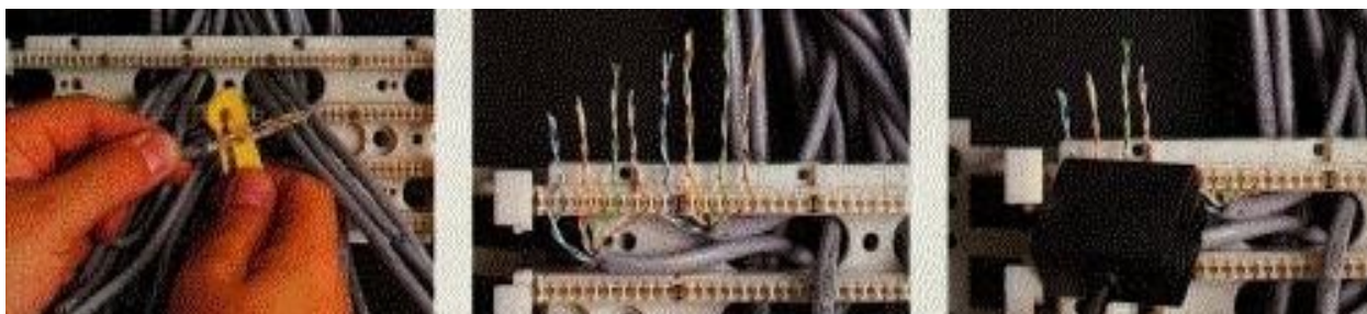
Figura. 7 - Sequência de instalação de cabos UTP. Observar o comprimento de pares destrançados limitado ao máximo de 13 mm.
